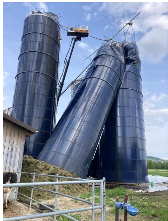
Abb. 4: Zusammenbruch eines Silos
