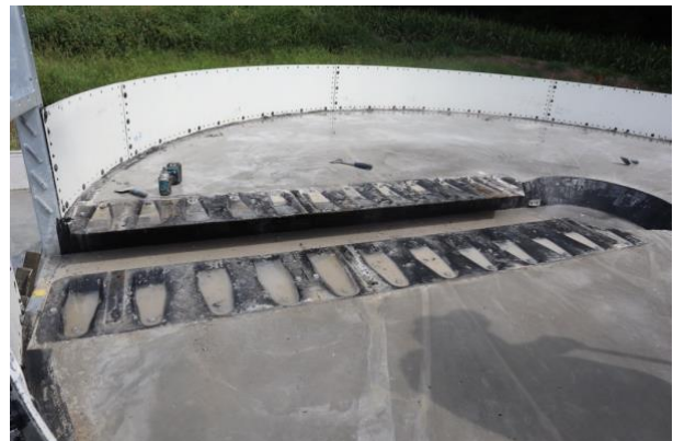
Abb. 9: Kanal für die Silofräse
