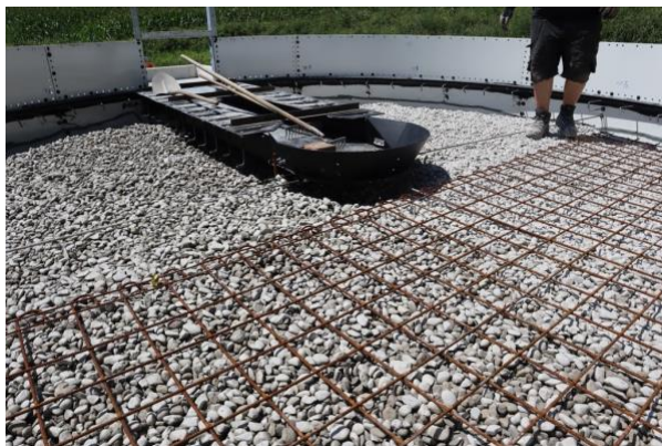
Abb. 8: Geröll mit Armierungsnetz
